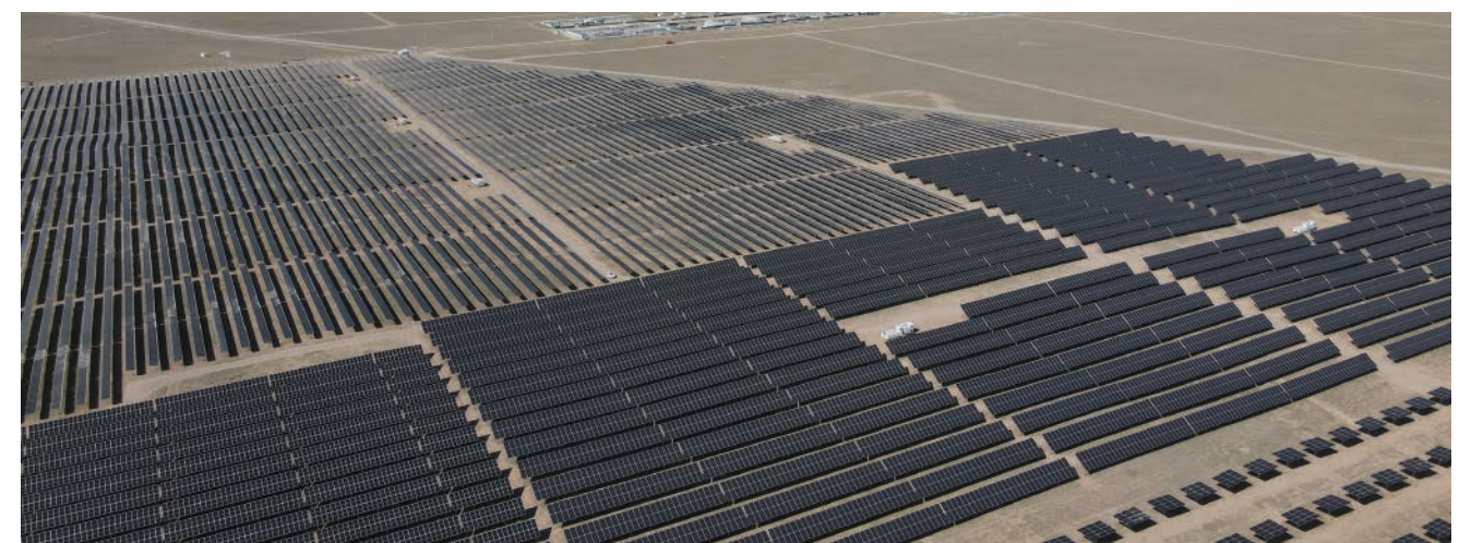
青海高海拔项目 安装时间：2024
